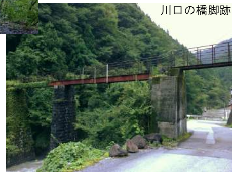
川口の橋脚跡
